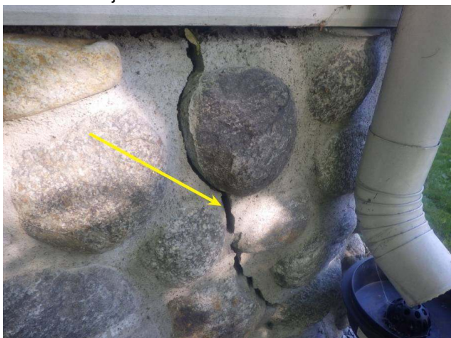
3. Sokkelipinnoitteen halkeama etunurkalla
