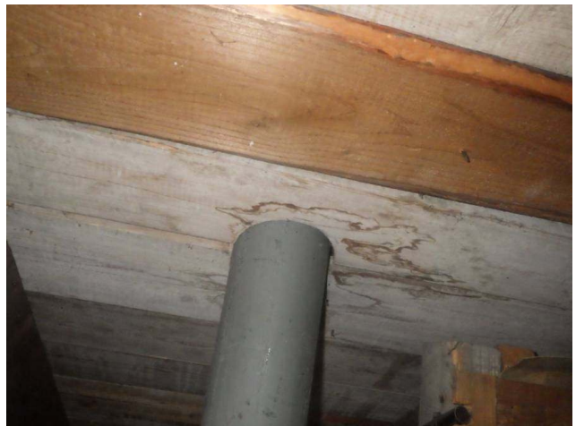
37. Viemärin tuuletusputkea ei ole eristetty ja läpiviennin kohdalla on valumajälkeä
