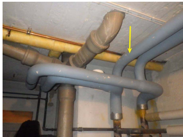
57. Teknisessä tilassa kulkevissa putkieristeissä voi olla asbestia
