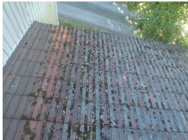
25. Tiilikatteen pinta on paikoin sammaloitunut
