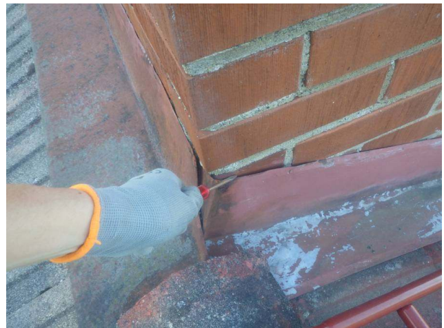
29. Piipun pellityksissä on epätiiveyttä
