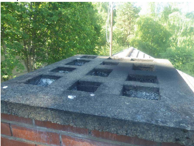
30. Piipun päällä ei ole sadehattua
