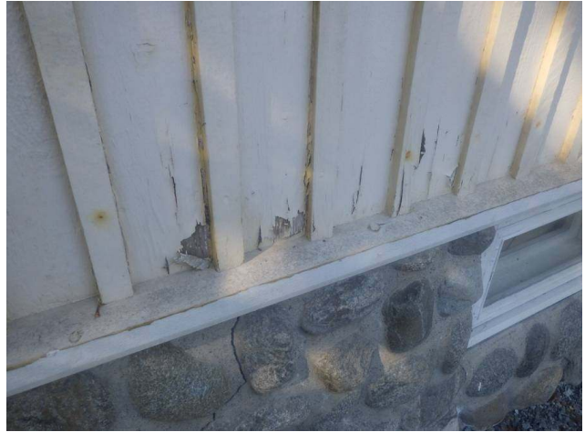
19. Maalipinta on paikoin hilseillyt irti
