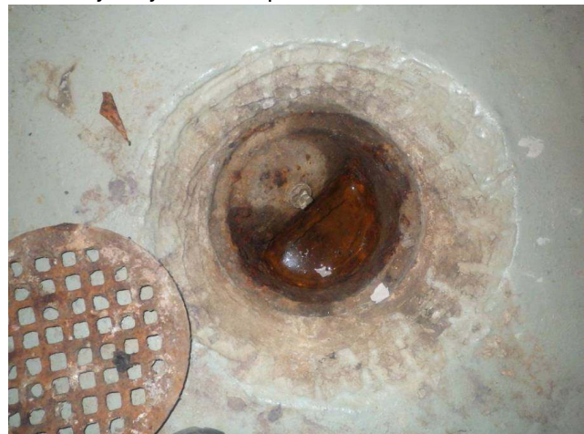
65. Teknisen tilan lattiakaivo on huonokuntoinen
