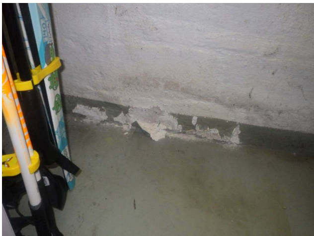
11. Maanvastaisen seinän alaosan kosteusvauriota aulatilassa
